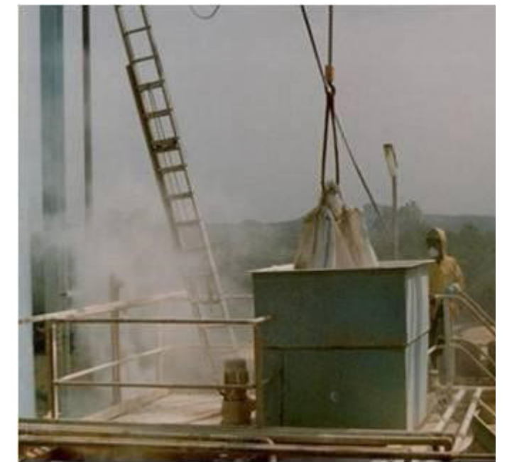
(Fuente: Universidad de Wollongong) Figura 9.1 - Carga de cal hidratada en Chute encima de tanques de mezclado de cianuro
