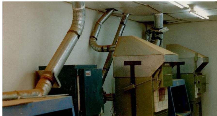
(Fuente: Universidad de Wollongong) Figura 9.3 - Sistema de ventilación en conductos de laboratorio
