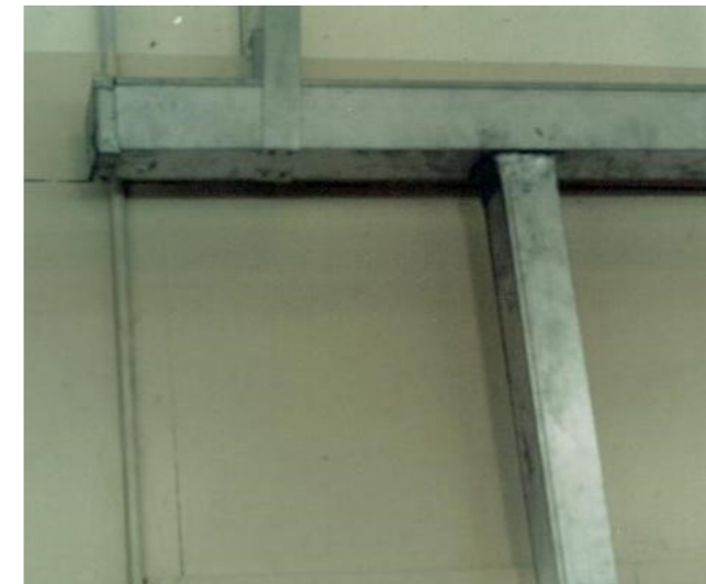
(Fuente: Universidad de Wollongong) Figura 9.5 - Primer plano de conjunto de ductos en “T”
